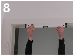
8 Richten Sie jetzt die Zarge mit der kleinen Wasserwaage zuerst in der Höhe aus.
